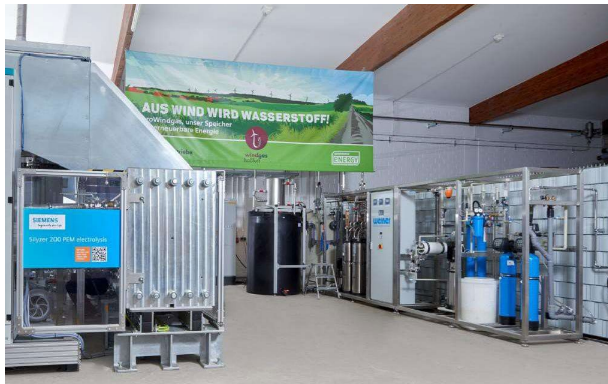
Abbildung 24: 1,25 MWel PEM-Elektrolyseur (links) mit Wasseraufbereitung (rechts) beim realen Betrieb in der Stadt Haßfurt [45]
